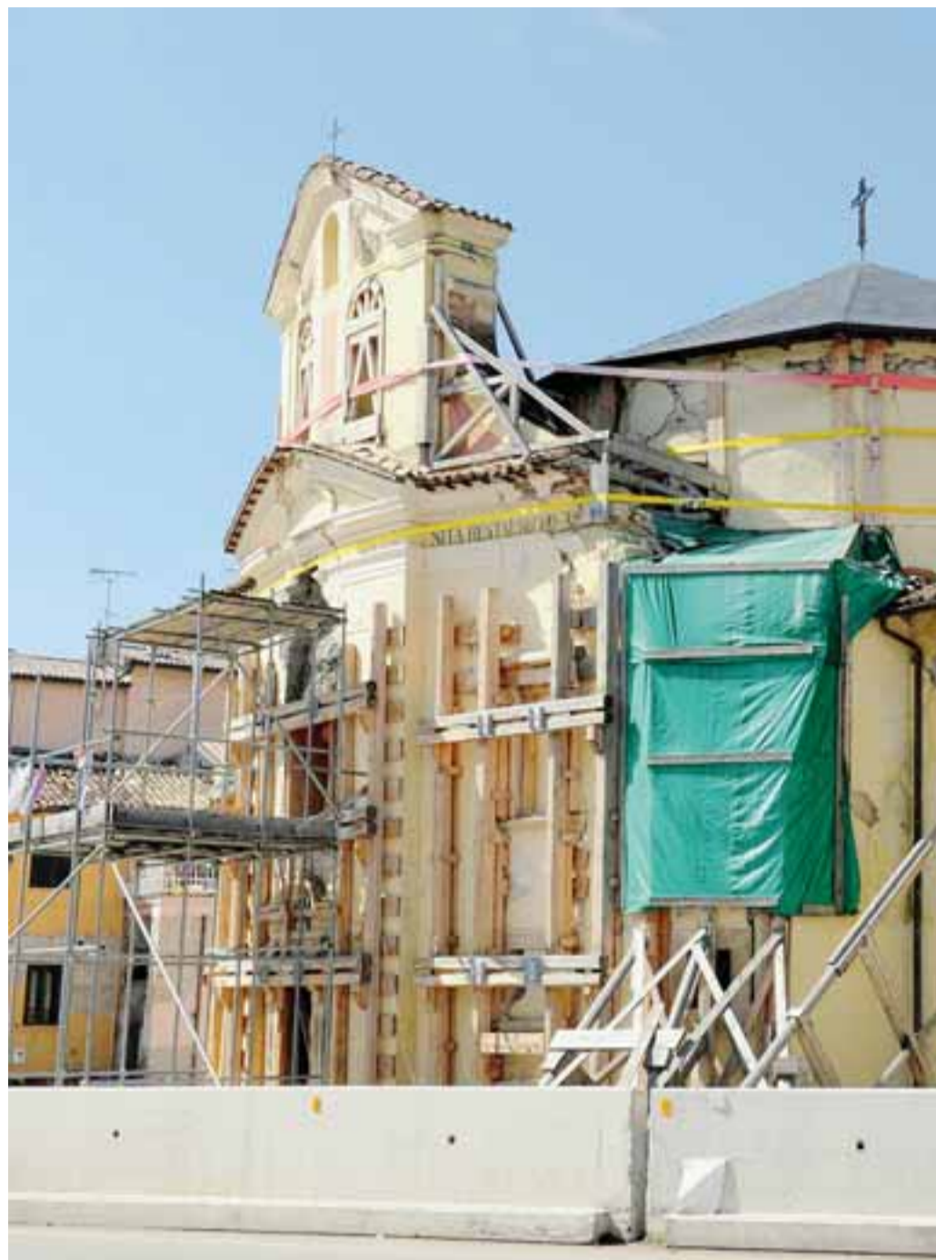
La chiesa di Paganica come si presenta oggi, a due anni dal terremoto FOTO ANSA
