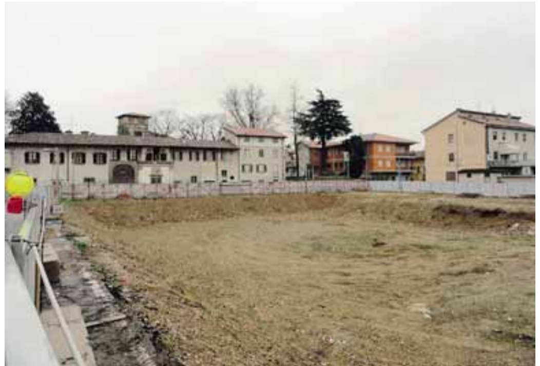
La voragine scavata davanti al castello Secco Suardo
